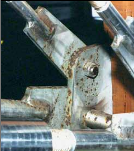
2 Flop: Korrosion an Edelstahlteilen nach wenigen Jahren
